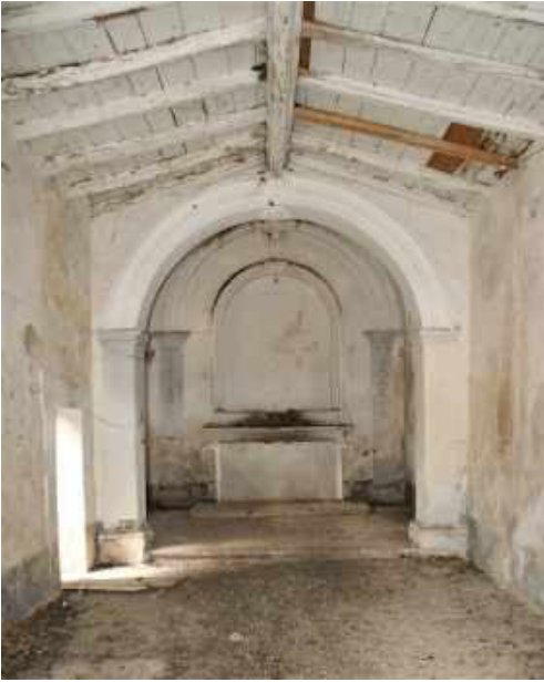
Figura 3. Interno della “chiesetta vecchia”, prima del crollo della copertura (2014).
