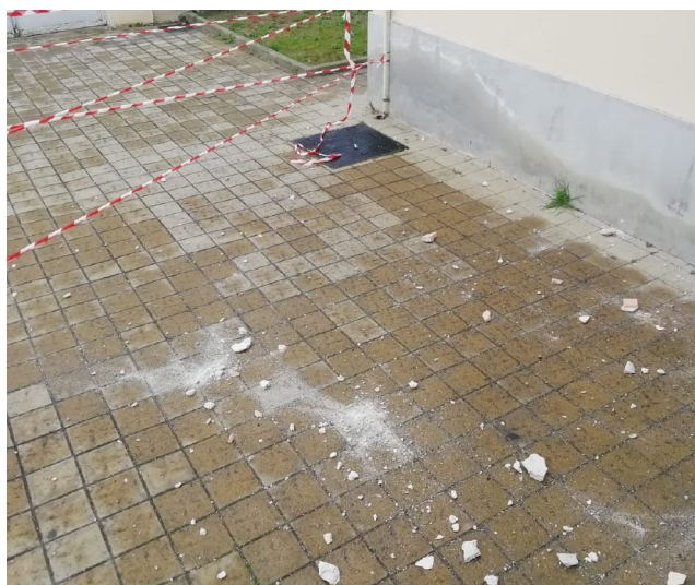
Fig. 43.2 - Il crollo della porzione di intonaco distaccata. (Foto Palma Sicuro 06/05/2021)
