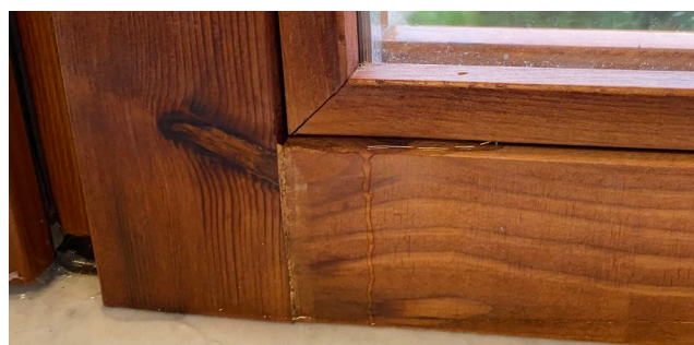
Fig. 5.4 - Dettaglio di anomalia del nuovo infisso a seguito dell'intervento di sostituzione del maggio 2021 (F.R. 25/11/2021)
