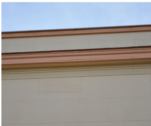
Fig. 43.1 - La lesione del cornicione rilevata durante il sopralluogo del dicembre 2020. (Foto F.R. 04/12/2020)
