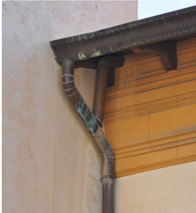
Fig. 4.1 - Guasto critico di un giunto tra due pluviali della scuola F.S. Cavallari di Palermo (Foto F.R. 2020)
