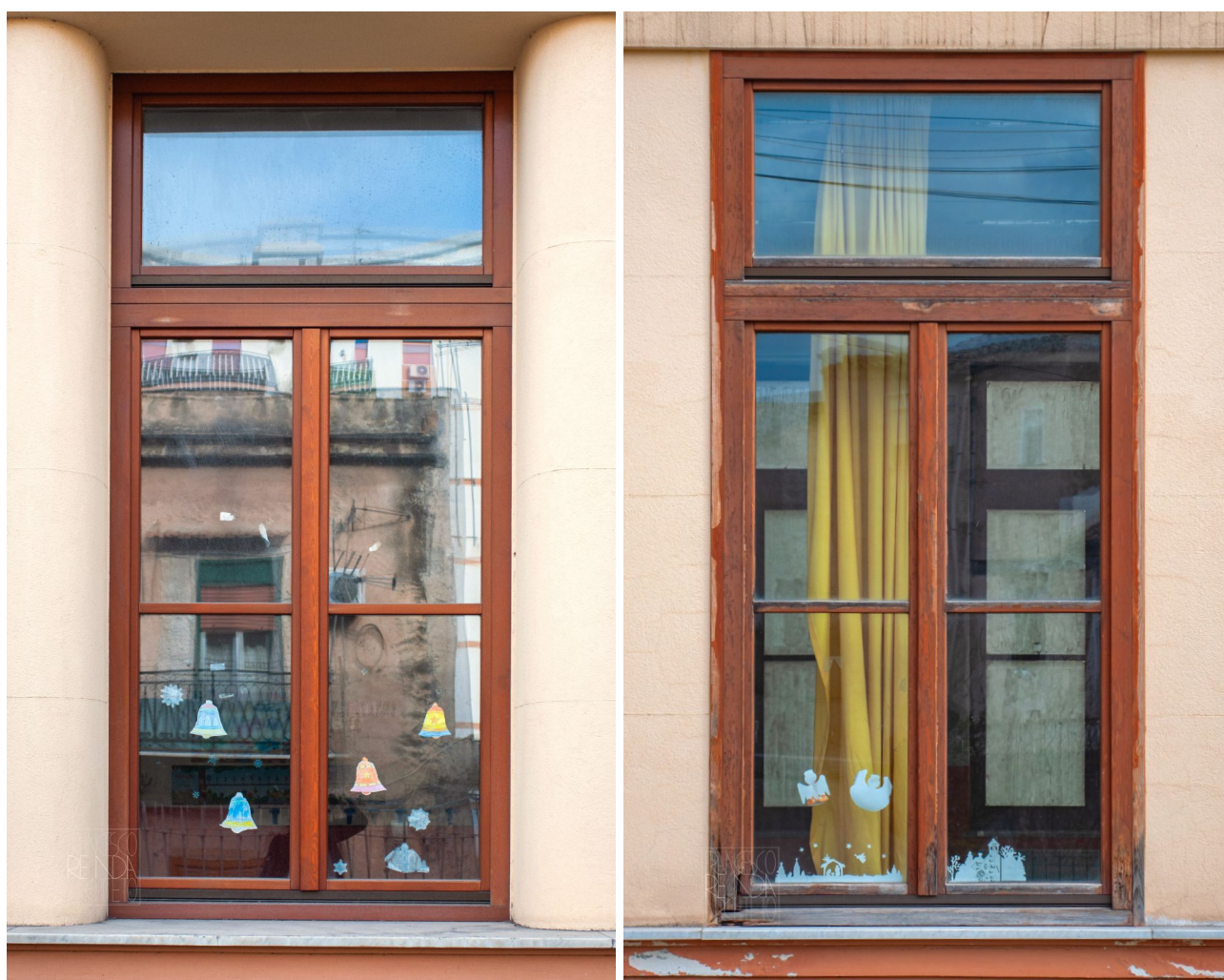
Figg. 46 e 47 - Due finestre della scuola F. Orestano, con caratteristiche identiche ma diverse condizioni di posa in opera, resta evidente il differente stato di conservazione attribuibile alla diversa collocazione rispetto al filo del muro ed alla diversa esposizione.
