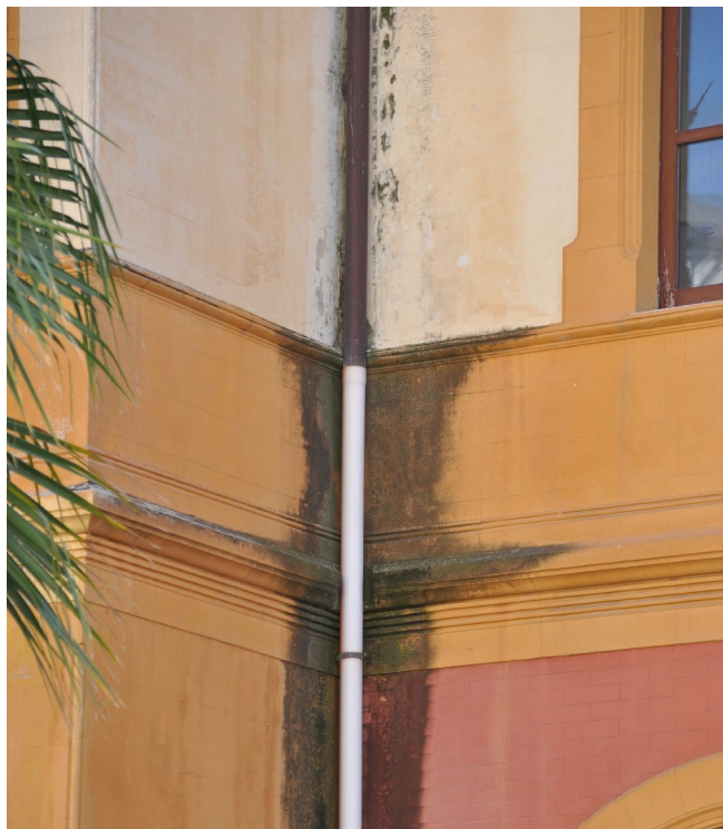
4.2 - I degradi conseguenti all'adozione di logiche di manutenzione differita (Foto F.R. 2020)
