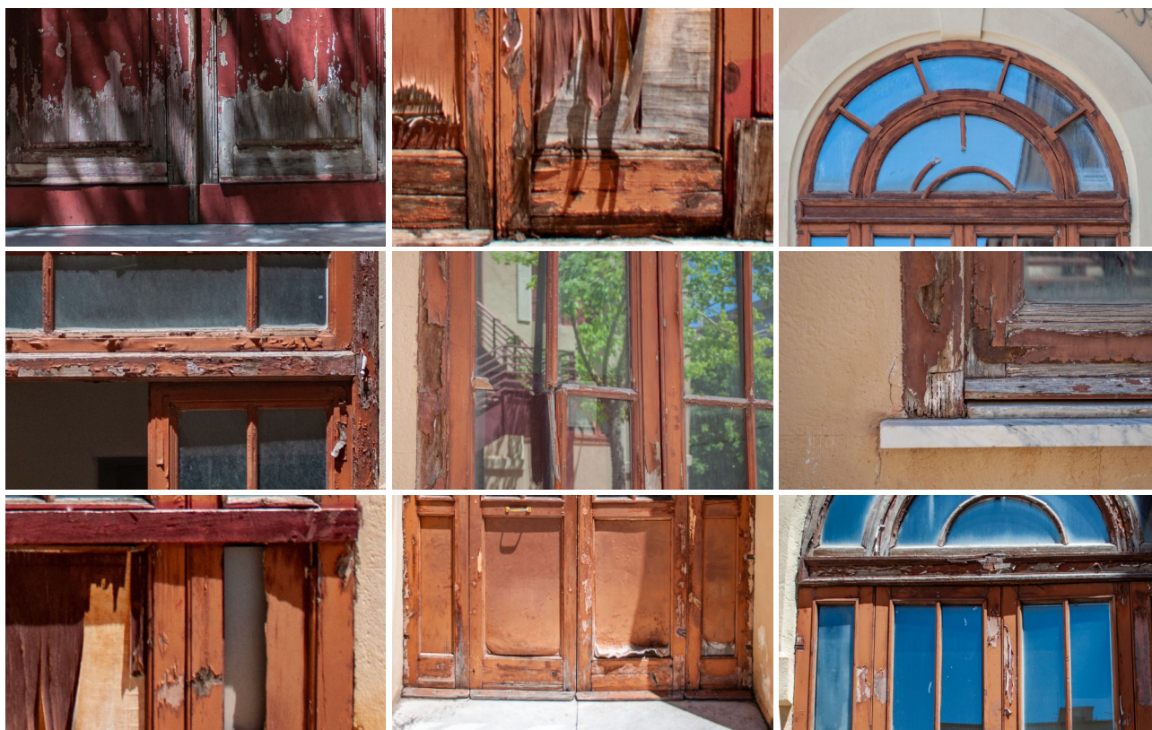
Fig. 52 - Alcuni dei degradi degli infissi esterni rilevati nella scuola L. Capuana
