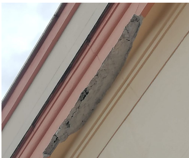
Fig. 43.3 - La parte di intonaco mancante e le evidenti ulteriori lesioni. (Foto Palma Sicuro 06/05/2021)
