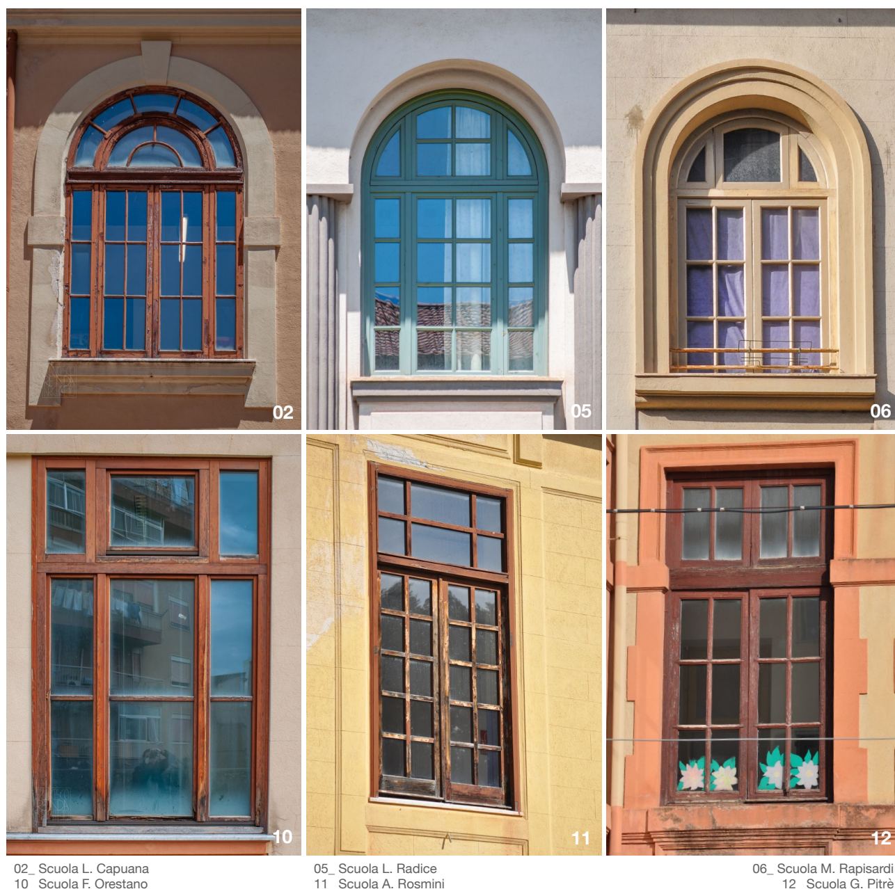
Fig. 50 - Un confronto tra le finestre di alcune delle scuole costruite a Palermo prima del 1945 (I numeri riportati fanno riferimento all'ID edificio dell'anagrafe immobiliare, Foto F.R. 2020/2022).
