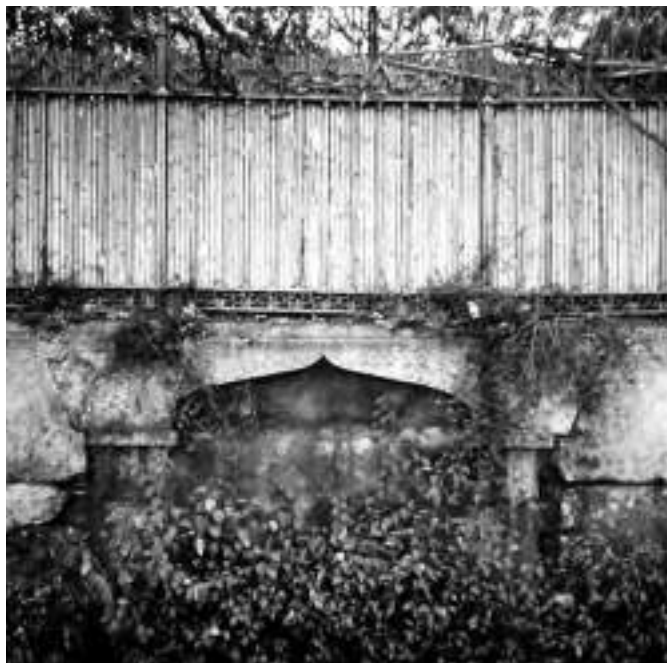
Fig. 44. Villa di Salvatore Monroy duca di Realmena al Giardino Inglese a Palermo, ante 1850, muro con nicchie ad arco carenato ribassato e cancellata di recinzione realizzata in analogia a quella del Giardino Inglese progettata da G.B.F. Basile, fotografia 2005 (E. Mauro)
