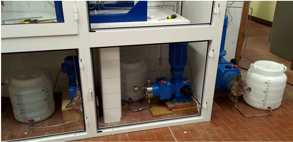
Figura 82 Pompe di alimentazione
