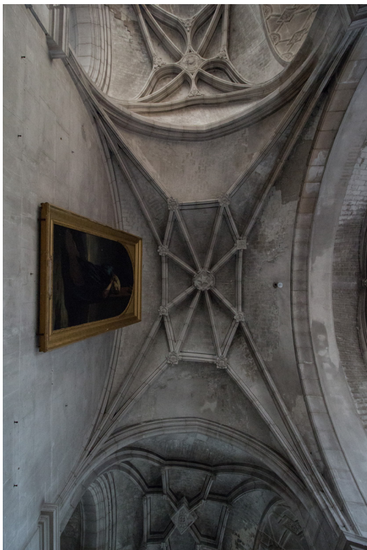
Fig. 38-39 Copertura delle navate laterali della chiesa di Saint-Jean, Joigny (foto a cura di G. Nuccio)
