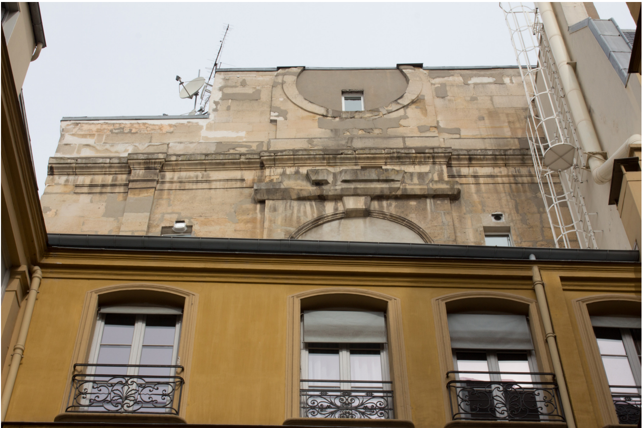
Fig. I , Parigi, presa fotografica delle rovine della chiesa di Sainte-Anne-la Royale dal cortile del 22 rue de Lille, 2015 (foto di G. Nuccio)
