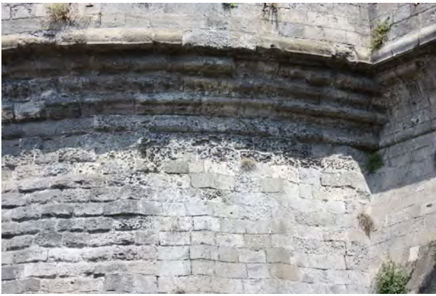
Fig. 5. Castelnuovo, Napoli. Progetto SNECS. Fenomeni di degrado del basamento in piperno della Torre della Guardia.
