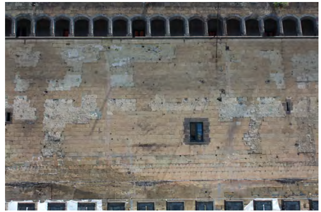
Fig. 6. Castelnuovo, Napoli. Progetto SNECS. Fenomeni di degrado del paramento in muratura di tufo della facciata sud.
