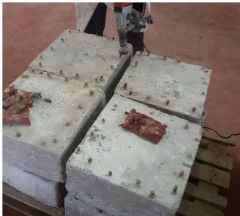
Figura 4.4 – Eliminazione dello strato superficiale di ruggine.
