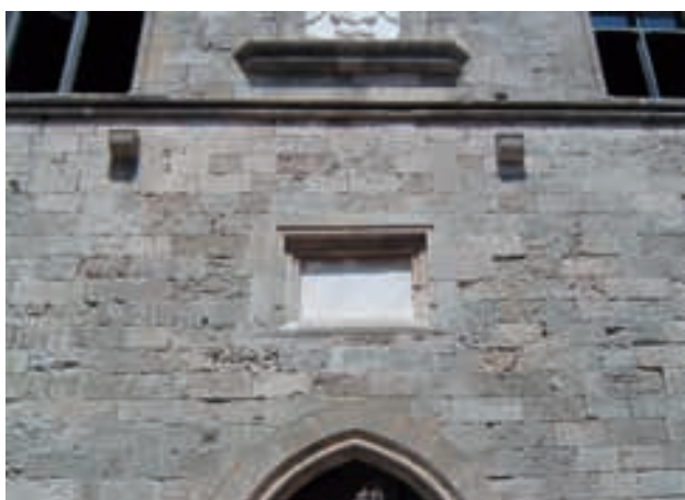
Fig. 82 - Rodi, via dei Cavalieri, facciate degli Alberghi (in primo piano a dx) della Lingua d'Italia e dell'Albergo della Lingua di Francia, 2006 Fig. 83 - Rodi, via dei Cavalieri, particolare della facciata dell'Albergo della Lingua d'Italia, 2006. In facciata vennero inseriti uno stemma marmoreo con le insegne del Gran Maestro Del Carretto e della famiglia Savoia e in basso una targa marmorea sui lavori di restauro Fig. 84 - Rodi, via dei Cavalieri, particolare della facciata dell'Albergo della Lingua d'Italia, 2006, particolare della targa collocata ma non presente nel 1933 in una foto dello Jacopi e non rilevata nel 1945 dal Paolini
