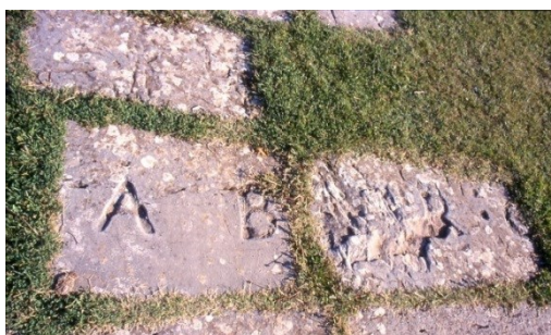
Figura 96. Sagome che gli antichi scalpellini ricavarono sul lastricato per posizionare le lettere in bronzo
