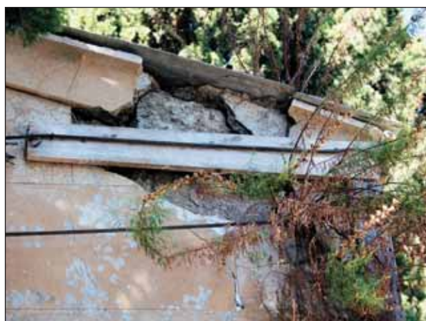
Fig. 4 – Monumento Gravina Bonanno, 1855, cimitero di Sant'Orsola, Palermo, particolare di una mancanza degli strati di intonaco dalla quale è possibile osservare la struttura dell'edificio composta da blocchi di roccia calcarenitica di colore grigio.
