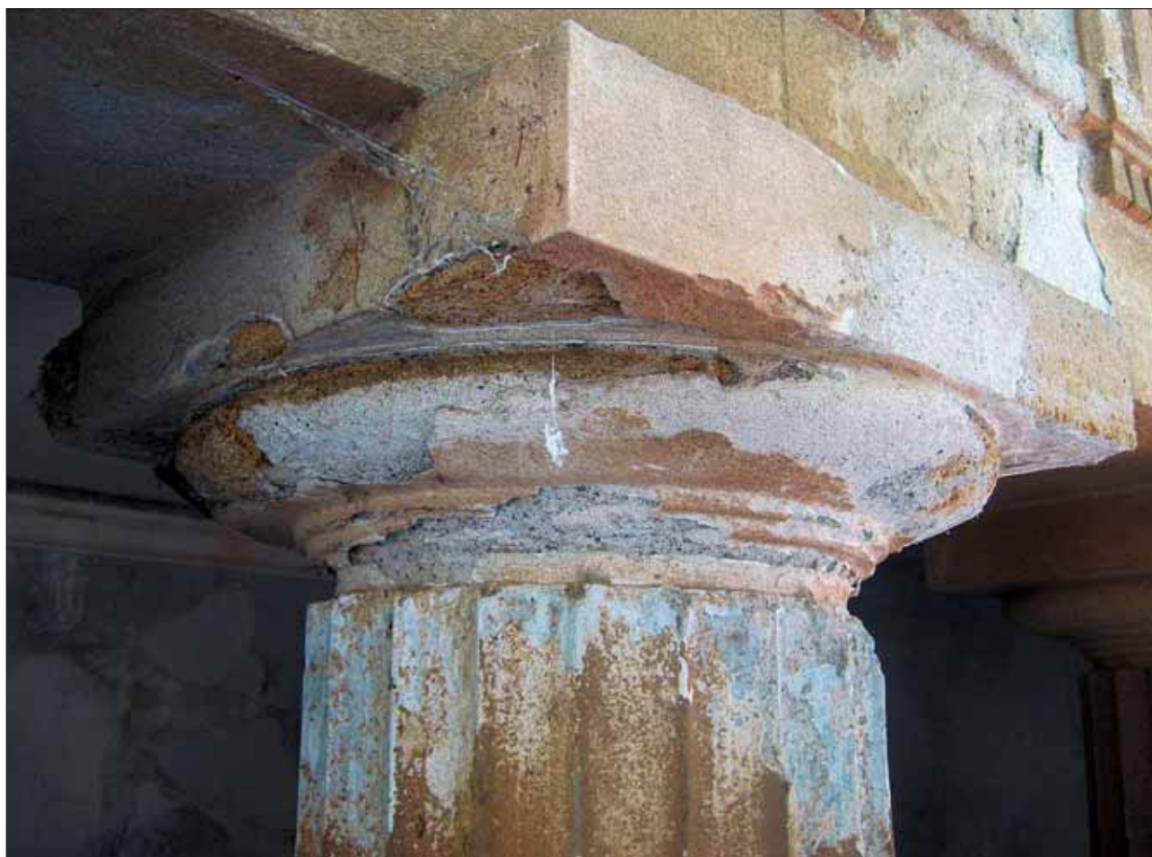
Fig. 18 – Monumento Gravina Bonanno, 1855, cimitero di Sant’Orsola, Palermo, mancanze e lacune in uno dei capitelli del pronao.
