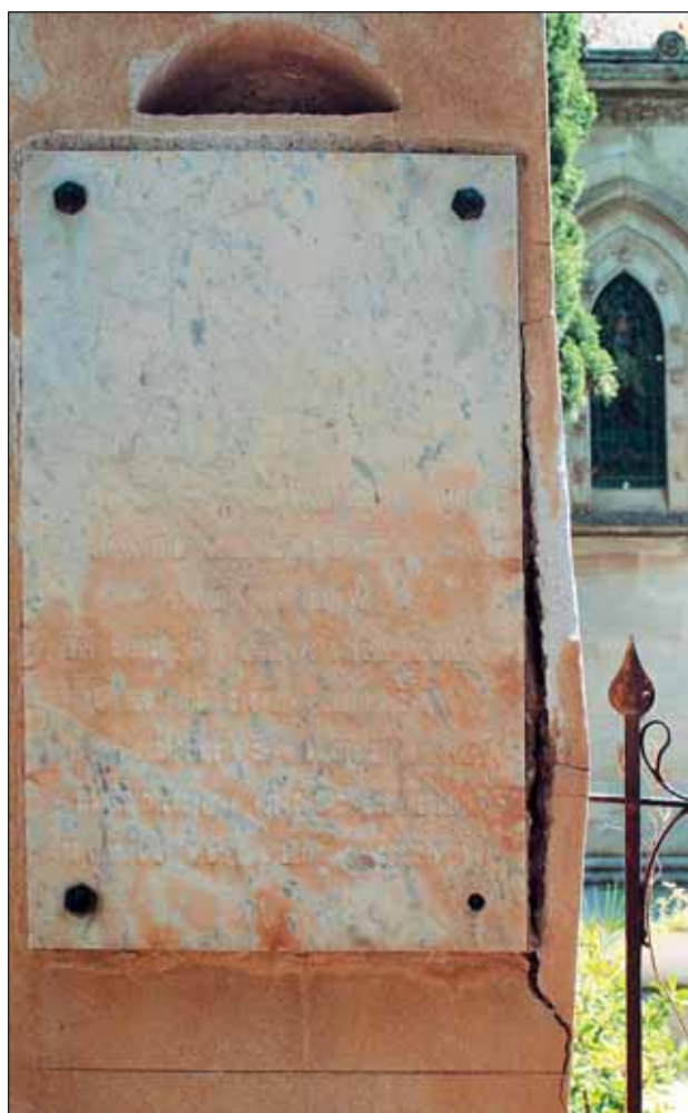
Fig. 17 – Monumento Gravina Bonanno, 1855, cimitero di Sant’Orsola, Palermo, particolare che evidenzia i difetti di adesione dei diversi strati di intonaco.
