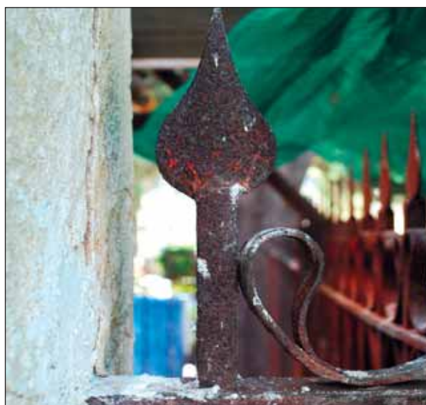
Fig. 23 – Monumento Gravina Bonanno, 1855, cimitero di Sant’Orsola, Palermo, particolare della recinzione metallica interessata da un evidente fenomeno di corrosione del materiale costitutivo.
