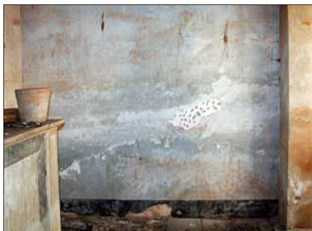
Fig. 26 – Monumento Gravina Bonanno di Montevago, 1855, cimitero di Sant’Orsola, Palermo, immagine della parete interna destra prima del restauro in cui sono visibili gli strati di rifacimento dell’intonaco e in particolare la fascia inferiore di colore scuro ad imitazione di una zoccolatura.
