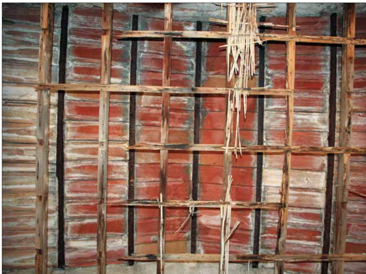
Fig. 24 – Monumento Gravina Bonanno, 1855, cimitero di Sant’Orsola, Palermo, ripresa dal basso dell’intradosso della copertura di rifacimento in cui si distinguono le travi in ferro IPE, il solaio ligneo e le tavelle in laterizio di colore rosso.
