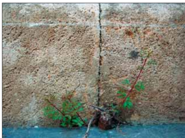
Fig. 13 – Monumento Gravina Bonanno, 1855, cimitero di Sant'Orsola, Palermo, particolare del muro perimetrale esterno in cui risulta evidente la crescita di vegetazione tra i conci di pietra.
