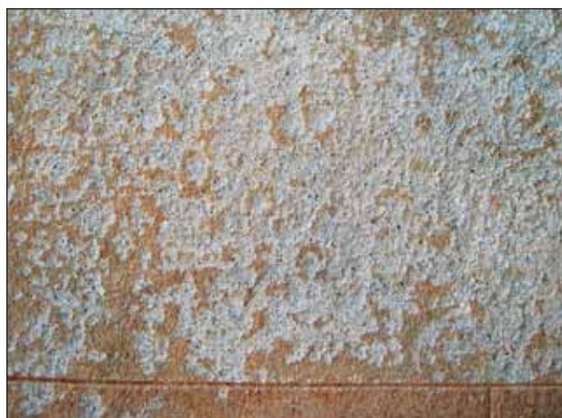
Fig. 20 – Monumento Gravina Bonanno, 1855, cimitero di Sant'Orsola, Palermo, fenomeno di erosione riscontrato sulle pareti esterne del monumento.
