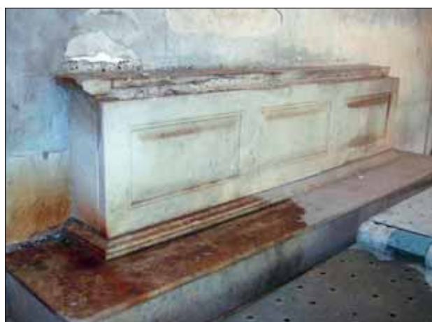
Fig. 21 – Monumento Gravina Bonanno, 1855, cimitero di Sant'Orsola, Palermo, dettaglio dell'altare in marmo durante l'intervento di restauro: l'immagine mostra le macchie di colore rossastro dovute alle scolature provenienti dagli elementi in metallo e legno alterati a causa dell'umidità.
