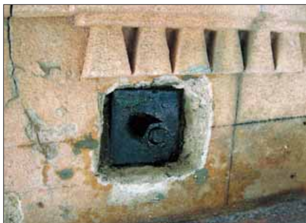
Fig. 28 – Monumento Gravina Bonanno, 1855, cimitero di Sant'Orsola, Palermo, foro passante realizzato sulla sommità delle murature per l'applicazione di tiranti in acciaio provvisti di piastre terminali ed apparati tenditori.
