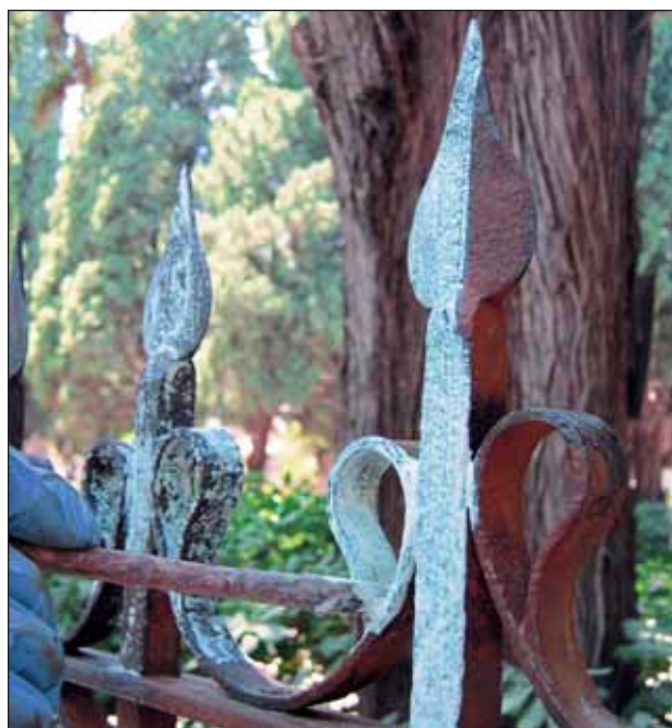
Fig. 34 – Monumento Gravina Bonanno, 1855, cimitero di Sant'Orsola, Palermo, applicazione a pennello di un inibitore di corrosione su tutta la superficie della ringhiera metallica.
