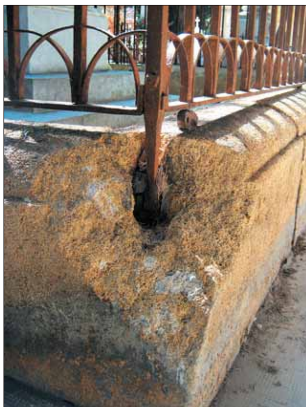
Fig. 11 – Monumento Gravina Bonanno, 1855, cimitero di Sant'Orsola, Palermo, particolare del muro perimetrale esterno interessato da una grave mancanza in corrispondenza dell'angolo.
