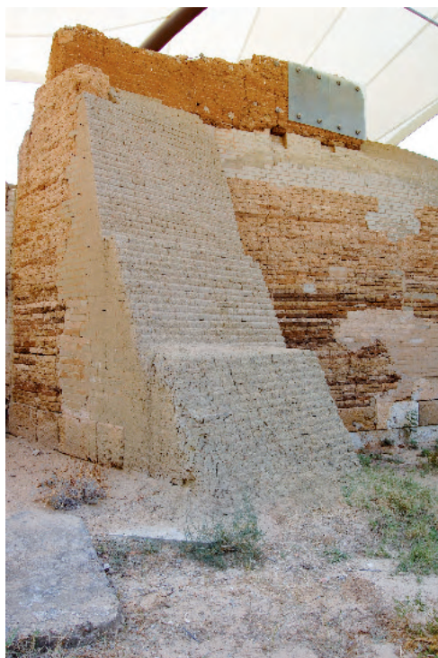
Fig. 7 - Gela, Capo Soprano: tratto delle mura timoleontee, che documenta i principali interventi conservativi realizzati negli ultimi cinquant'anni, dai cristalli progettati da Franco Minissi al contrafforte in mattoni crudi suggerito da Eugenio Galdieri. La tensostruttura della copertura non aggetta abbastanza per evitare gli effetti della pioggia battente, come evidenzia il notevole deterioramento dei mattoni crudi di nuova realizzazione (2015).
