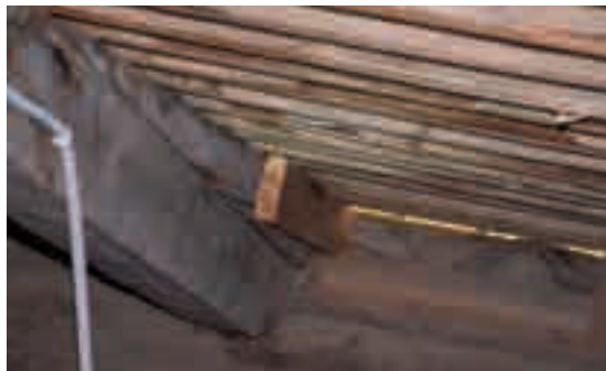
7.2.c - L'intervento su questo elemento ligneo mediante l'aggiunta di una tavola non è efficace. Ha la unica funzione di ridurre la pendenza del tetto nella parte terminale più bassa ed è semplicemente compresso perpendicolarmente alle fibre.
