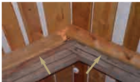
8.1.a - Sostituzione parziale di un puntone. È sempre meglio procedere senza la sostituzione completa.
