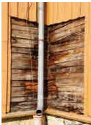
3.1.d - Sistema Blockbau danneggiato dall'acqua.
