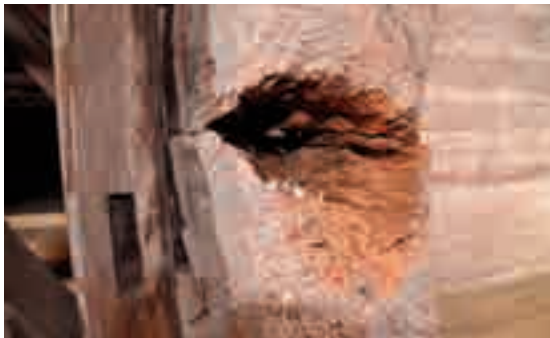
7.2.a - Deterioramento dei tronchi del sistema Blockbau dovuto dall'infestazione da tarli. Bisogna rimuovere le parti ammalorate ed inserire le nuove parti di legno solidarizzate con resine epossidiche (vedasi Fig. 37).
