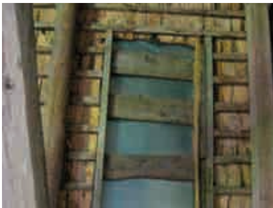
3.2.c - Degrado antropico dovuto alla realizzazione in copertura di una apertura incongrua.
