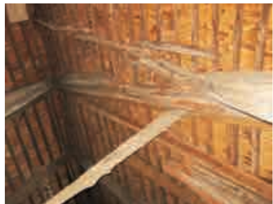
3.2.e - Rottura della parte terminale di un puntone.
