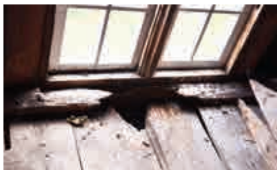
7.1.a - Danni dovuti a infiltrazione d'acqua in corrispondenza dell'infisso e del tavolato del pavimento. Rimossa la causa, successivamente devono essere sostituite le tavole della pavimentazione.
