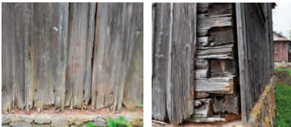
Figg. 2, 3 - Il rivestimento dei setti verticali lignei è uno degli elementi sostituiti più spesso. La mancanza di manutenzione dei rivestimenti esterni può portare a danni irreversibili.
