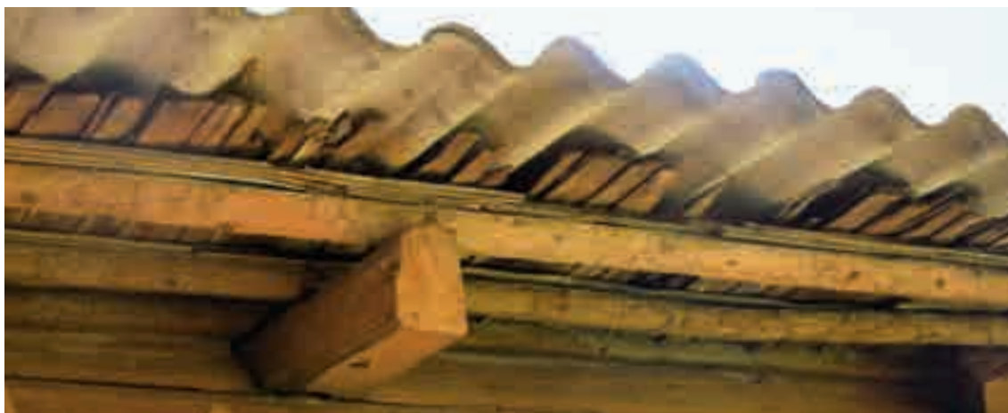
Fig. 50 - Il nuovo rivestimento della copertura in lastre di fibrocemento realizzato sopra il vecchio strato di tavole lignee favorisce il degrado del tavolato.
