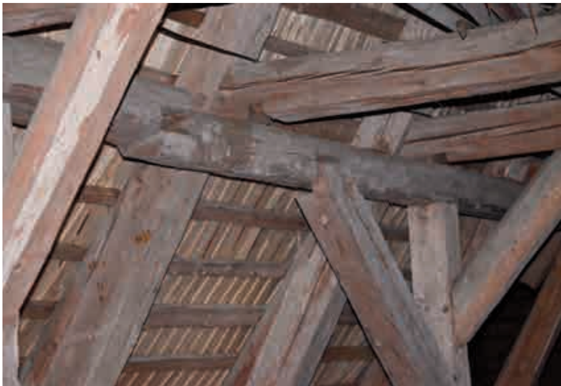
Fig. 34 - Tutti i nodi delle incavallature sono sconnessi a causa delle fessurazioni da ritiro.
