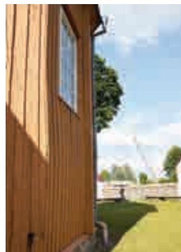
3.1.e - Deformazioni del rivestimento esterno dovuto a disconnessioni del supporto.
