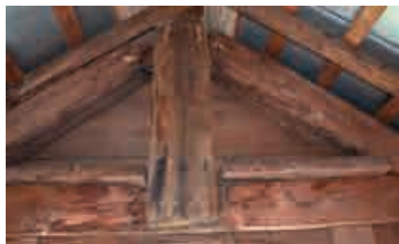
7.1.c - Colmo dell'incavallatura danneggiato da infiltrazioni d'acqua. La struttura non è più in grado di sopportare i carichi. Bisogna rimuovere le parti danneggiate e procedere con protesi lignee concordate con barre di vetroresina.
