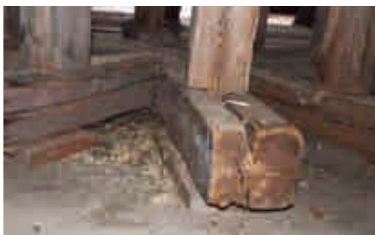
7.1.b - Fessurazioni longitudinali collegate attraverso una cipollatura. In questa zona le fessurazioni non sono pericolose, perchè la trave inferiore non rimane libera.
