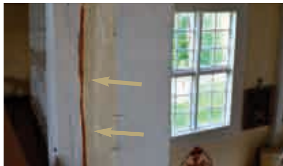
4.1.d - Spazio tra i setti lignei ed irrigidimento verticale dovuto al asciugamento del legno, riempita con incongrua schiuma poliuretanicca.
