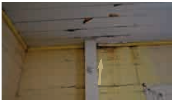
4.1.c - Verniciatura distaccata dei setti verticali a causa di infiltrazioni di acque meteoriche laddove il manto di copertura non assicura una coretta impermeabilizzazione.
