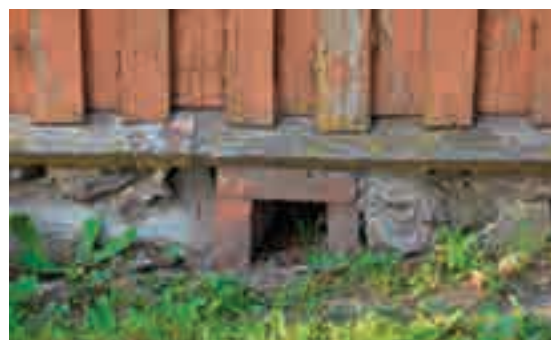
Fig. 44 - In passato, si preferiva aprire fori direttamente nelle fondazioni, per garantire una buona ventilazione di tutte le strutture basamentali.
