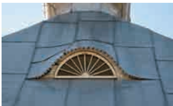
Fig. 41 - Nella zona dei sottotetti si era soliti installare finestre che garantivano una buona ventilazione delle strutture della copertura, in qualunque periodo dell'anno.
