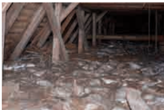
Fig. 49 - Il vecchio rivestimento dopo lavori di manutenzione della copertura lasciato nel sottotetto a marcire.
