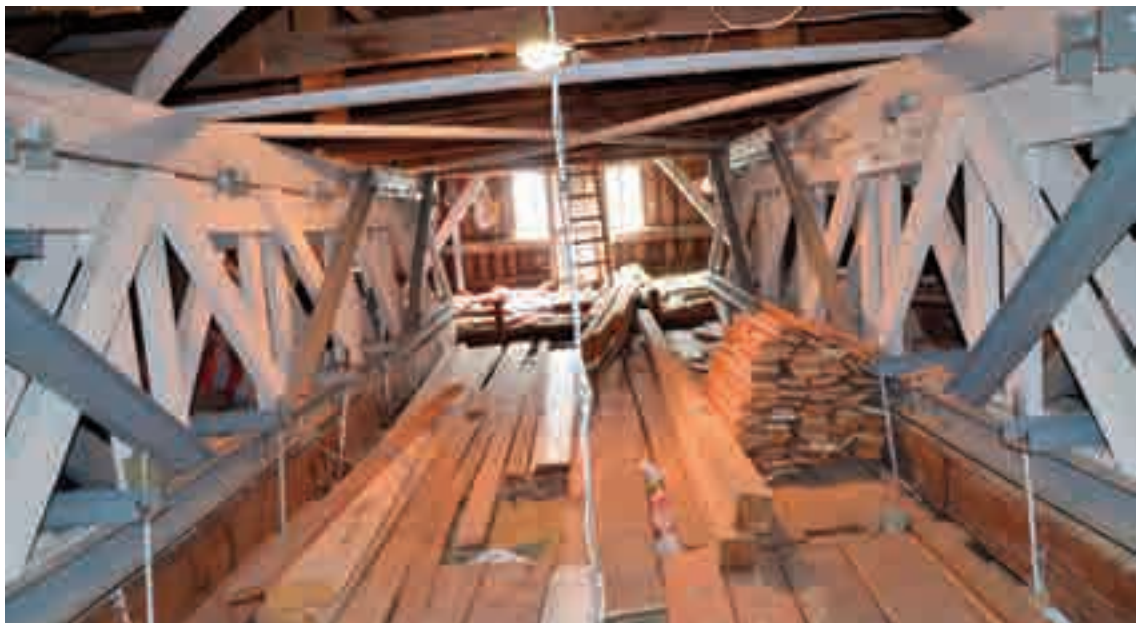
8.2.c - Il progetto di consolidamento mediante due travi reticolari in legno e acciaio non è corretta, perchè invasivo e tende sovraccaricare la struttura esistente.
