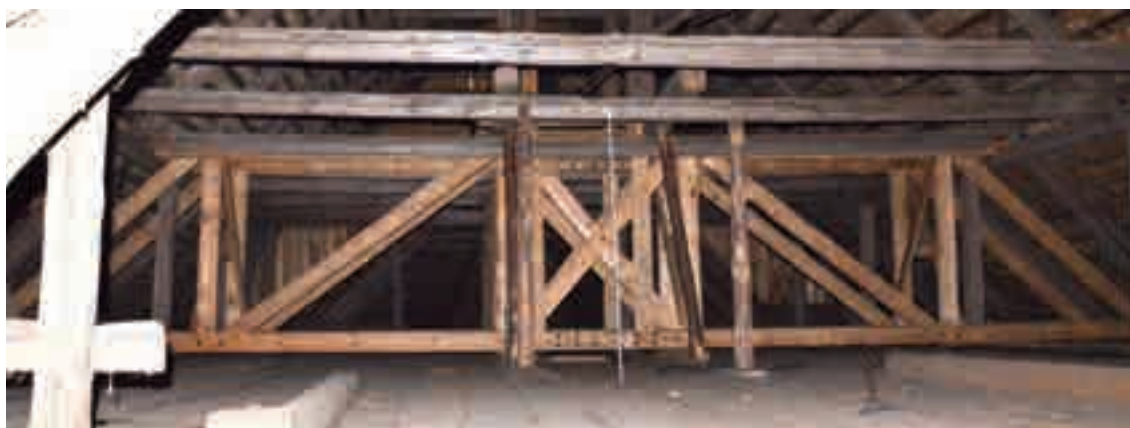
9.1.c - Sistema d'irrigidimento per scaricare il peso della torre centrale appoggiata sui setti verticali lignei.
