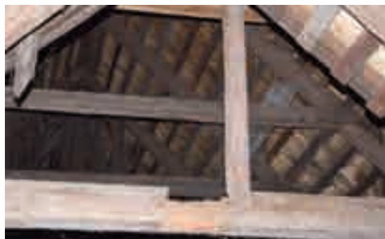
9.1.b - Alloggiamento di un monaco mancante. Bisogna riempire lo spazio vuoto con legno duro.
