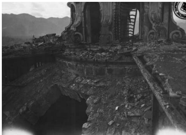
62. Palermo, chiesa del SS. Salvatore, particolare della cupola danneggiata dai bombardamenti (Soprintendenza Beni Culturali e Ambientali di Palermo, su concessione dell'Assessorato per i Beni culturali e l'Identità siciliana della Regione siciliana. Dipartimento regionale dei Beni culturali e l'Identità siciliana).
