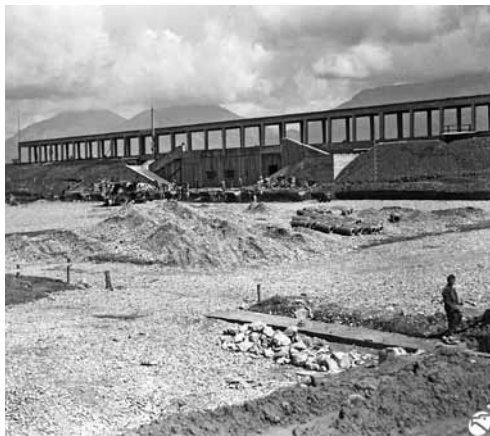
4. G. Bosio, Stadio olimpico, 1939-40, fasi dei lavori di costruzione, foto d'epoca (Roma, Istituto Luce, Occupazione italiana dell'Albania)
