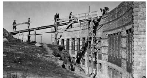
8. C. Valle, Convitto femminile, Tirana , 1940-43 ca., fasi dei lavori di costruzione, foto d'epoca (Roma, Istituto Luce, Occupazione italiana dell'Albania)
