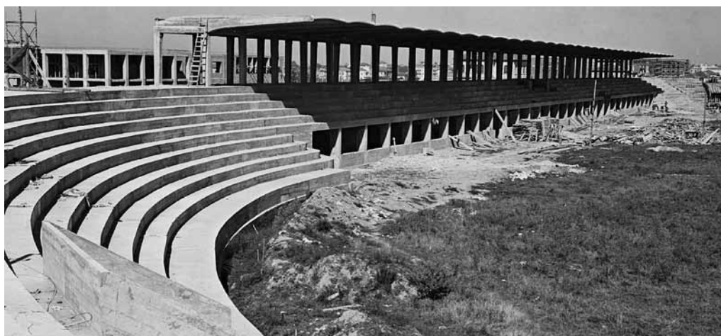
5. Stadio olimpico e Casa della Gioventù Littoria Albanese (oggi sede del Museo Archeologico di Tirana e della Biblioteca Universitaria), 1939-40, fasi dei lavori di costruzione, foto d'epoca (Roma, Istituto Luce, Occupazione italiana dell'Albania)
