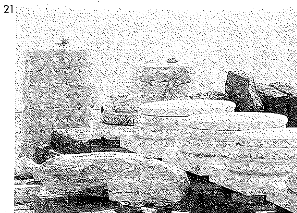
FIGURA 21 • Pergamo (Turchia), tempio di Traiano, restauri in corso. La serie di basi in pietra, accuratamente lavorate e pronte per la posa in opera, sta a dimostrare che, una volta imboccata la strada del ripristino, è difficile fermarsi. Ciò sia perché la stessa comprensione filologica del monumento, se non filtrata da vigili criteri di restauro, spinge verso la riproposizione al vero di quanto essa ha desunto dallo studio dei frammenti superstiti; sia perché le parti originali, venerande ma invecchiate e corrose, mal sopportano il confronto visivo con le copie finto-antiche, risultando agli occhi di molti osservatori, come scrive W. Wolters, "ancora più misere".
