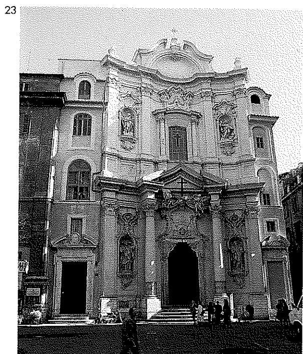
FIGURA 23 • Roma, chiesa della Maddalena, facciata (XVIII secolo), restauro delle superfici. Giunta sino a noi in condizioni ragionevoli d'invecchiamento, la facciata ha subito tuttavia un pesante restauro a metà degli anni settanta, con ridipintura totale sostanzialmente monocroma e "focature" o spugnature a fingere quella patina d'antico che l'intervento aveva fatto sparire. Di recente è stata nuovamente restaurata seguendo una linea di ripristino dei colori settecenteschi che suscita gravi dubbi non solo sul piano metodologico ma anche su quello filologico, il quale avrebbe dovuto costituire la base inoppugnabile del lavoro. Si tratta infatti d'un testo architettonico che pone problemi storiografici e attributivi molto complessi, tuttora in gran parte irrisolti, per cui ipostatizzare una "situazione originale" che può non essere mai esistita appare qui, ancor più che in altri casi, assurdo.
