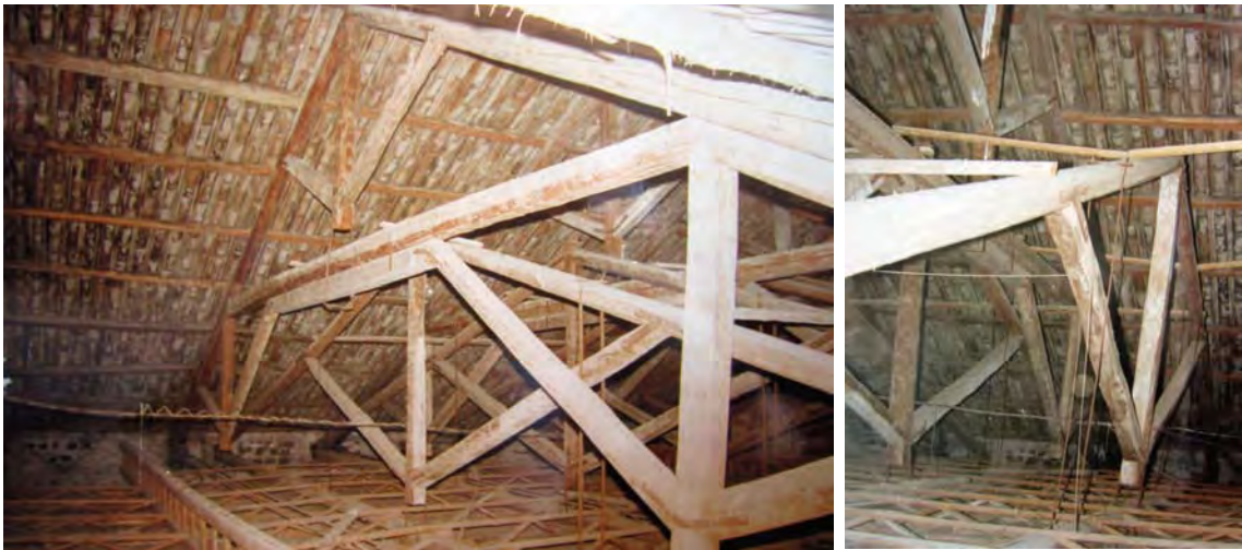
Particolare della copertura e del controsoffitto della sala (anni '80). ©Comune di Adrano.
