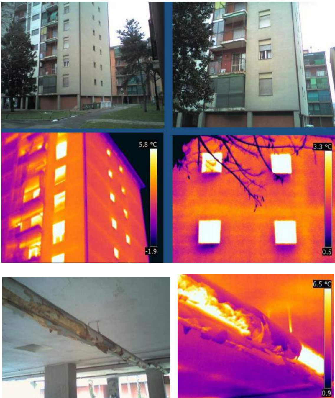
Fig. 3.26 - Immagini prodotte dai rilievi e dalle indagini termografiche condotte sull'involucro esterno dei corpi edilizi 1-3 dell'edilizia sociale. © Cened.
