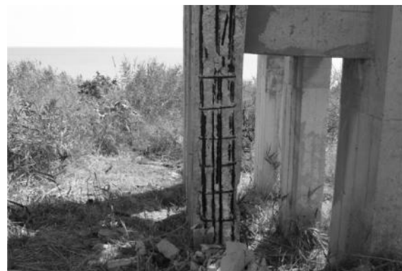
Figura 2 - Degrado delle pile del viadotto Maddalusa
