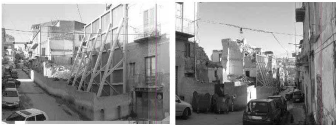
Fig. 5 – Favara, area dei crolli (tratto dalla Tesi di laurea di Calogera Tarantino, Dal disastro dei crolli alla risorsa del paesaggio degli spazi pubblici).
