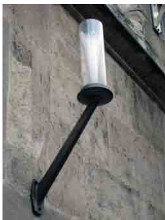
Fig. 5.34 Particolare dell'illuminazione, all'ingresso del Museo.
