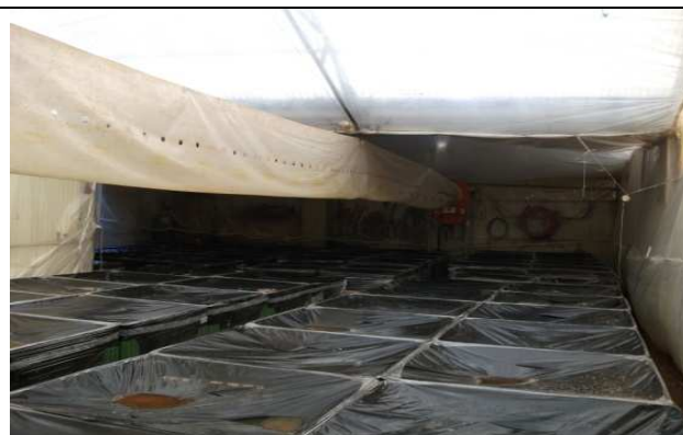
Foto 35: Guaina adibita alla distribuzione di aria calda nella camera di forzatura.
