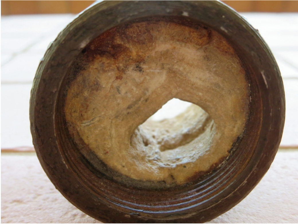
Foto 2. Incrostazione calcarea all'interno di un tubo in ferro di un impianto idraulico. Photo 2. Fouling limestone inside a tube in iron of a hydraulic system.
