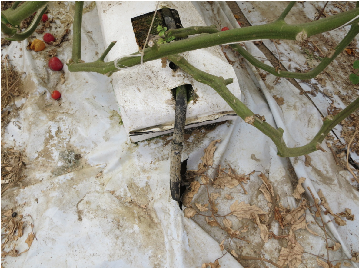
Foto 1. Incrostazione calcarea su un tubo dell'impianto di irrigazione in una serra.
