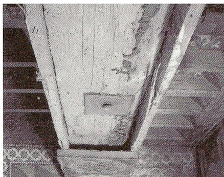
Fig. 3 - Rimuovendo il pannello inferiore della trave n. 18 si evidenziano dei camminamenti praticati dalla specie Reticulitermes lucifugus : è un segno della presenza di gallerie termitiche all'interno della sezione della trave.
