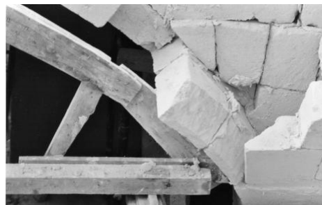
Fig. 3 - Particolare della centina, nella costruzione in un cantiere diretto dal Prof. Capoccia a Mesagne (BR) nel 2003
