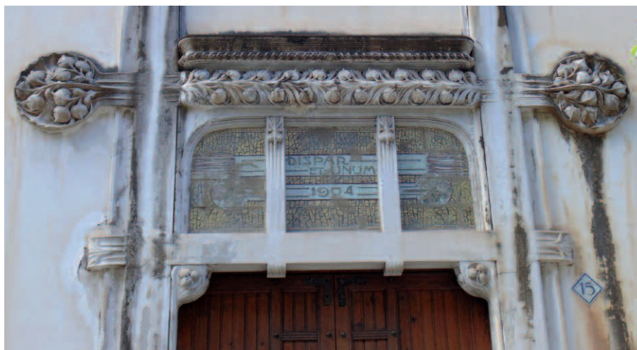
Fig. 23: Palermo, villa Basile, in primo piano i degradi nel coronamento del portale di ingresso. (G. Castrovinci)
