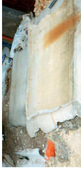
Fig. 6: Materiali fortemente compromessi - rifiuti speciali.
