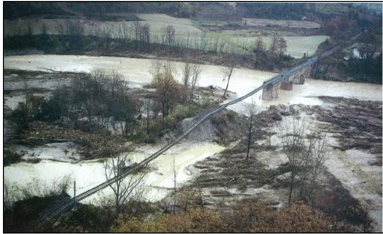
Fig.2.2.1 Castellino Tanaro. Il rilevato ferroviario è stato portato via dalla piena con la stessa dinamica con cui si rompono gli argini.
