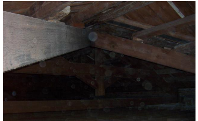
Dispensario Diurno (1920-28), E. Basile, Palermo; foto delle travi in legno della capriata del Dispensario
