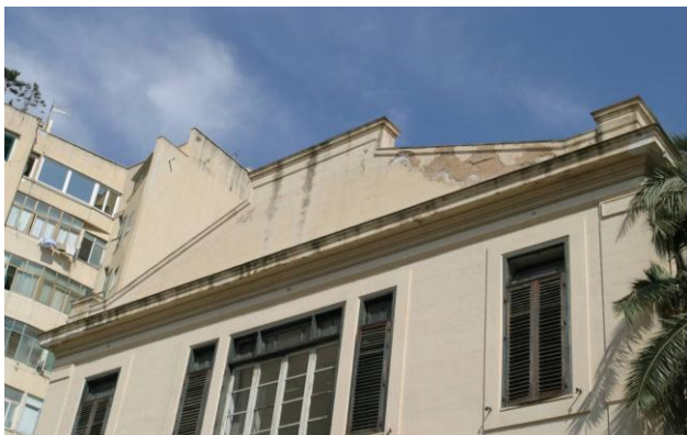
Dispensario Diurno (1920-28), E. Basile, Palermo; foto del coronamento della corpo centrale del Dispensario, con timpano spezzato con rialzo centrale. Lo scrostamento dell'intonaco nella porzione di spazio sulla sinistra farebbe intendere una diversa coloritura dell'edificio
