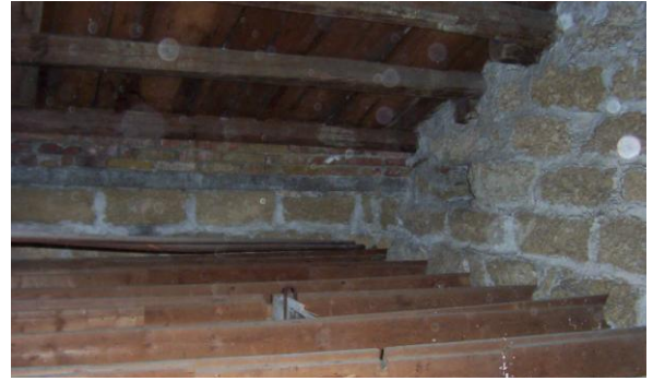
Dispensario Diurno (1920-28), E. Basile, Palermo; foto delle travi in legno della copertura del Dispensario visibili dal sottotetto
