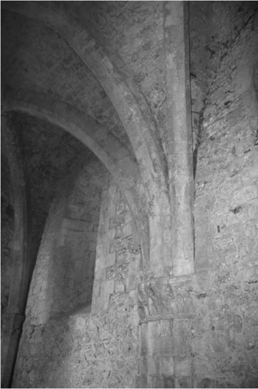
Figura 3 Detalle del apoyo del arco mediano y de los nervios de las bóvedas adyacentes en la capilla del castillo de Mussomeli (foto de la autora 2013)
