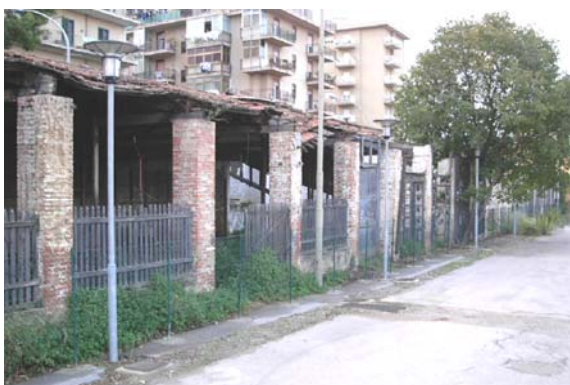
Foto 6 – Fatiscenza della struttura
