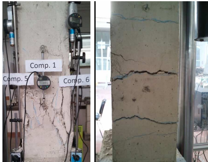
Figura 4.44 - Lesioni nella zona tesa e nella zona compressa
