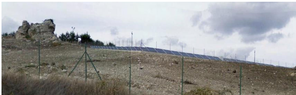
Figura 37 - Foto del generatore fotovoltaico. In mezzo, tra le schiere è possibile vedere uno dei quattro quadri di campo (string box).
