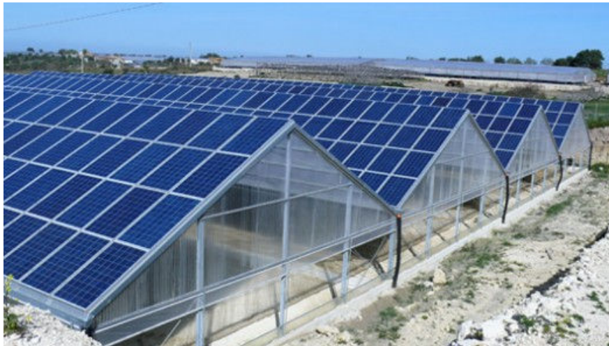
Figura 11 - Serra fotovoltaica: struttura a doppia falda con impianto su falda a SUD.
