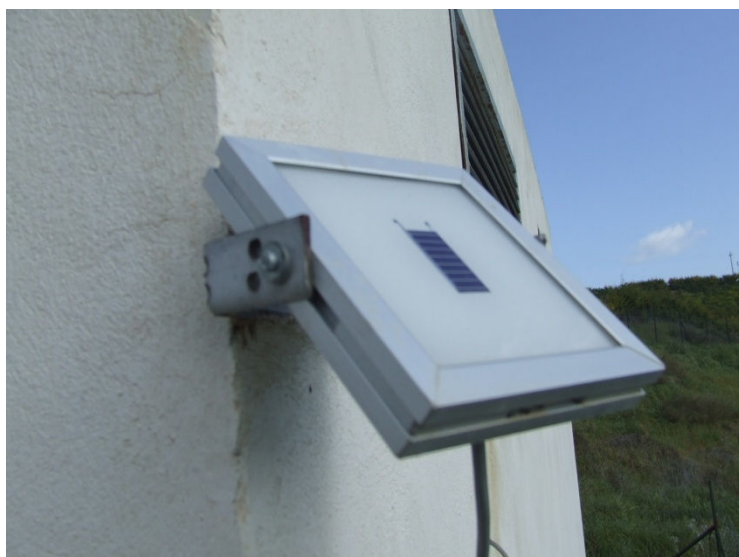
Figura 40 – Particolare del solarimetro con cella policristallina, installato sulla parete del vano inverter.
