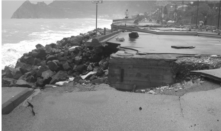
Figura 3.1 - Infrastruttura viaria danneggiata nel 2003 durante una mareggiata. Lungo mare di Sant'Alessio Siculo in provincia di Messina (litorale ionico).
