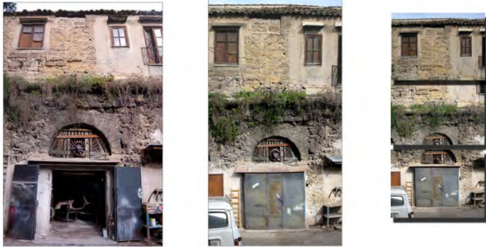
Fig. 6.17 - Confronto tra le prese fotografiche e la successiva mosaicatura dei tre fotogrammi, che ricoprono la superficie di un modulo del fronte su Via Dattero; la foto a sinistra è stata realizzata con la fotocamera digitale reflex Nikon D50 con punto di presa da terra; la scarsa profondità di campo dà un'immagine aberrata non idonea a successive elaborazioni. Per il fotopiano di destra, si è utilizzato il sistema semi-automatico sviluppato dalla SYS Scarl costituito da un'asta in fibra di vetro che ha permesso di effettuare riprese aero-fotogrammetriche ad una quota di 15 mt., permettendo così una corretta presa ortogonale del fronte da restituire graficamente.
