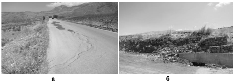
Рис. 1. Деформации дорожного полотна (а) и разрушение подпорных стенок оползневыми массами (б)
