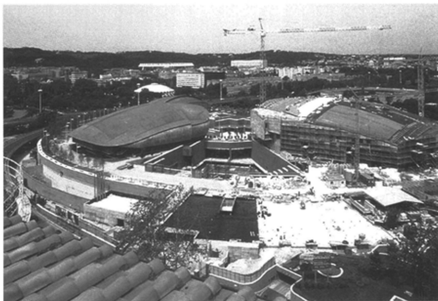
Auditorium di Roma, Renzo Piano. Veduta del cantiere (foto Gianni Berengo Gardin)
