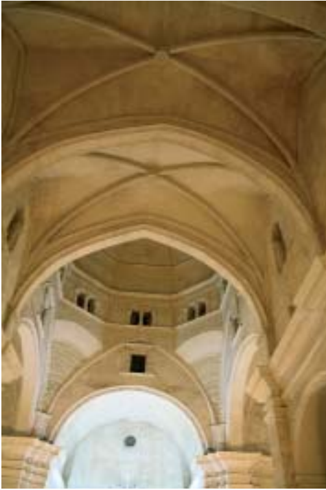
Fig. 5. Sassari. Chiesa di Gesù e Maria. Veduta del sistema voltato di copertura sull'aula.
