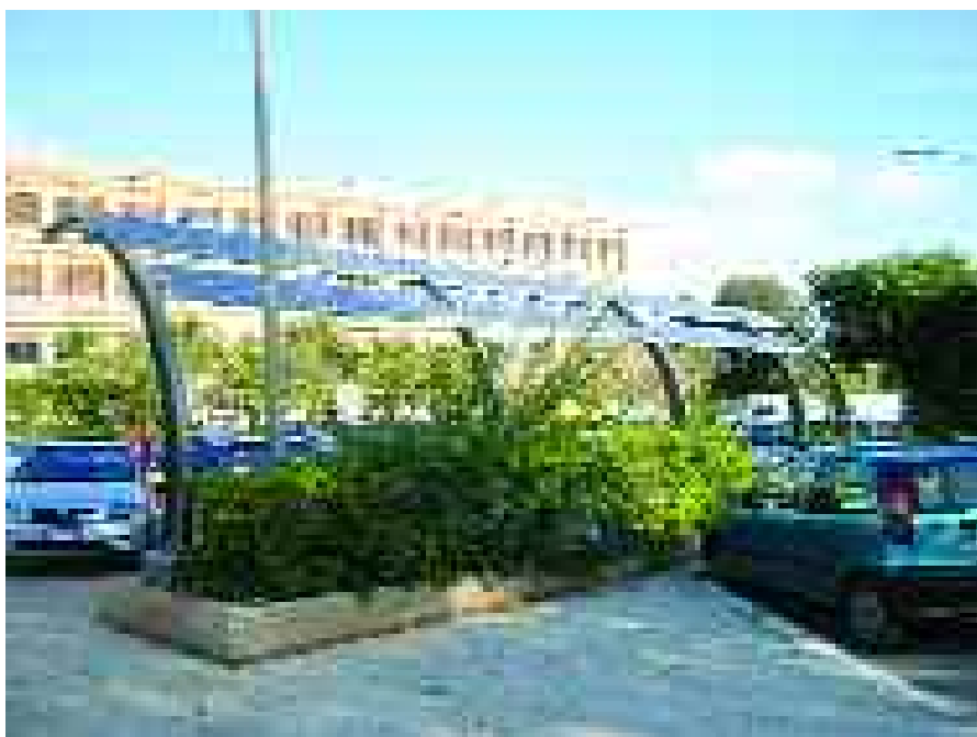
▲ Foto 1 - Impianto da 20 kW parzialmente integrato in elementi di arredo urbano, Campus Universitario Palermo.
