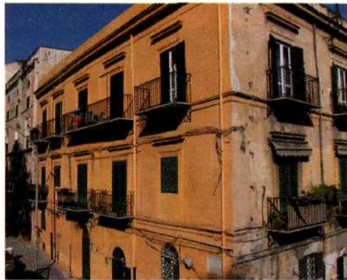
Palermo, palazzetto in piazza della Vittoria in prossimità del palazzo dei Normanni. Uno dei due prospetti con intonaco Li Vigni è stato recentemente verniciato con prodotti acrilici.
