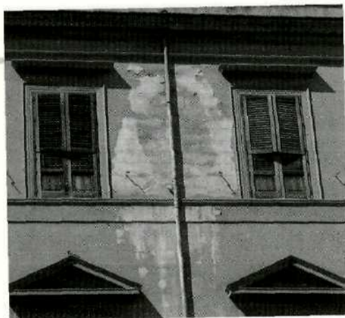
Palermo, classico esempio di uno dei tanti prospetti decorati con intonaco a finta pietra, "restaurati" tramite pitture acriliche che presto si distaccano.
