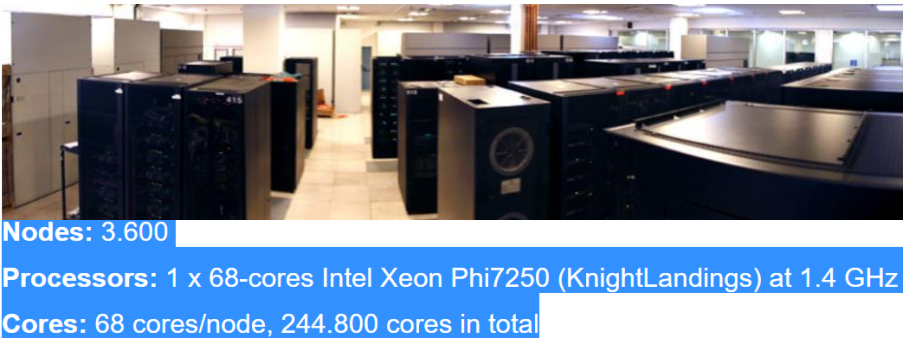
Figura 5. la sala macchine del CINECA (Bologna), con il supercomputer utilizzato per le simulazioni (MARCONI). Maggiori informazioni sul sistema possono essere trovate sul sito ufficiale http://www.cineca.it
