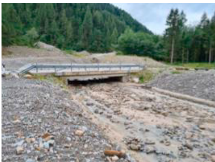
Fig. 2. Obstructed bridge after a debris flow event on the Rio di Croda Rossa (Anterselva, BZ). Courtesy of Agenzia per la Protezione Civile della Provincia Autonoma di Bolzano.
