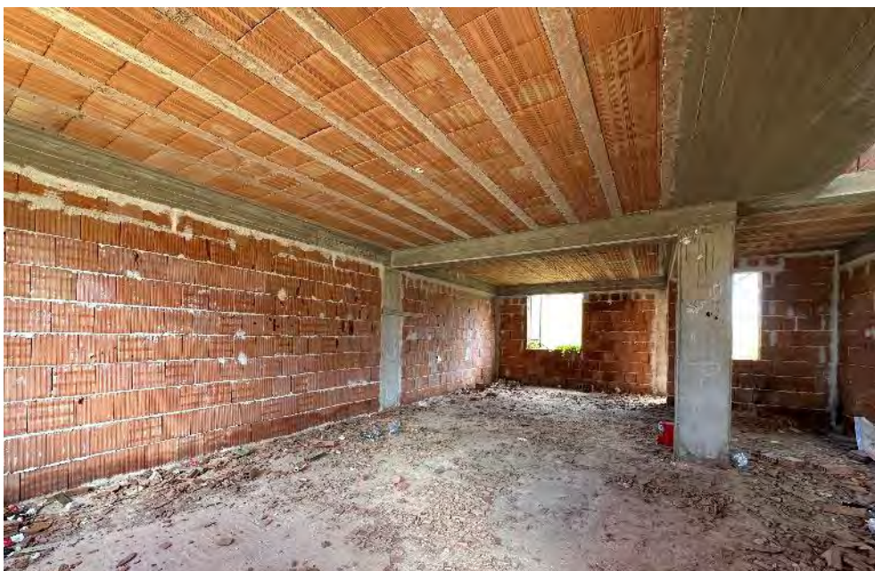
Fig. 115 | Vista interna del Corpo B in cui è stata effettuata l'installazione (F. Anania, settembre 2023)
