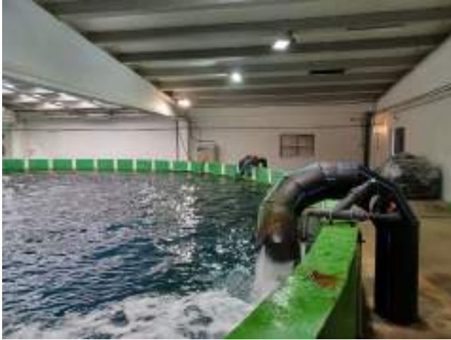
Figura 7. Sistema de impulsión de agua en el tanque.
