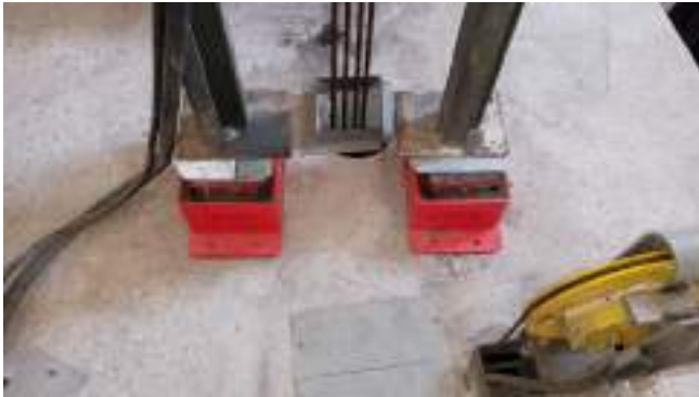
Figura 4. Apoyos elásticos instalados a posteriori en el grupo tractor de un ascensor tradicional. Se aprecia en la esquina inferior derecha que el sistema paracaídas no dispone de apoyos, creando un punto de transmisión de vibraciones a la estructura.
