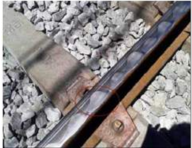
Figura 5. Desgaste ondulatorio en un raíl.
