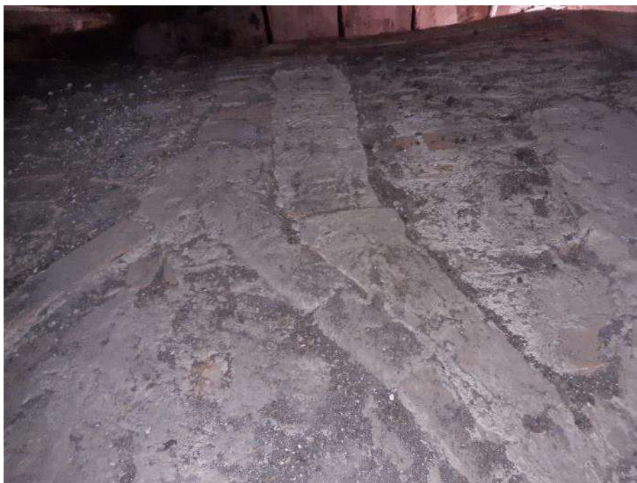
Figura III.15. Estradosso di una volta realina con nerature applicate all'intersezione tra lunette e volta principale (foto dell'Autore).
