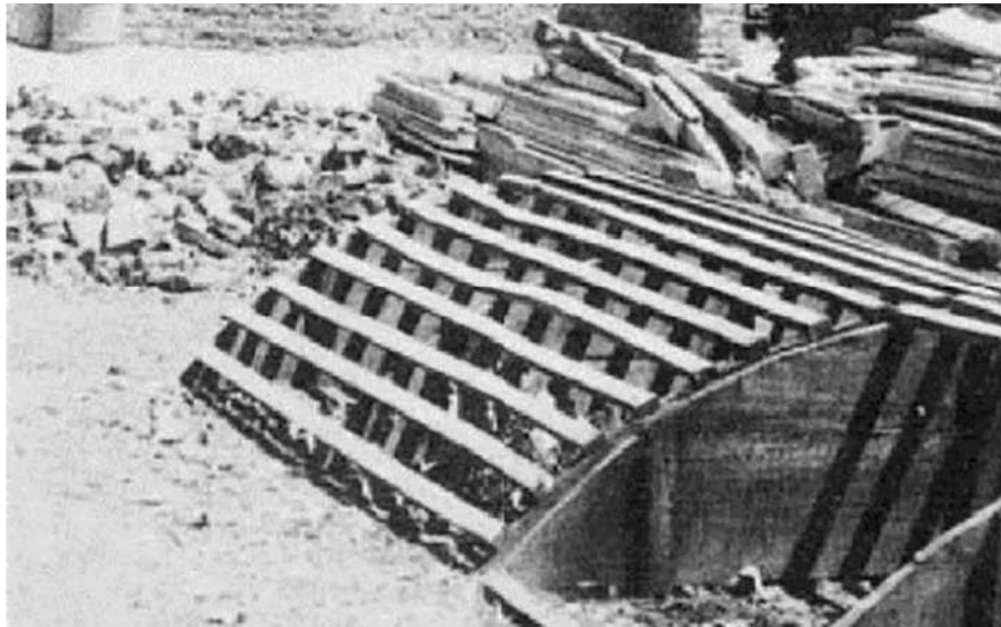
Figura II.48. Cassaforma in legno utilizzata per le volte di Casa Robert (Sacriste et al., 2012).
