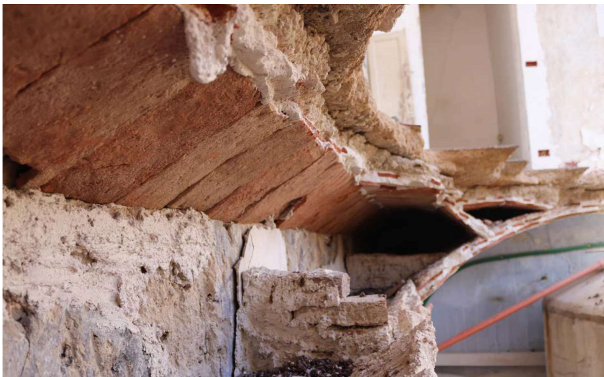
Fig. 8. Elementi di rinforzo di una volta a botte parzialmente crollata in via Levatrice a Partinico; si riconoscono due frenelli in mattoni e gesso e, in secondo piano, la sagoma della controvoletta e della doppia controvoletta (foto di D. Giardina).
