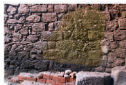
2. EFFLORESCENZA E PATINA BIOLOGICA
