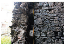
1. SCOLLAMENTO MURATURE ADIACENTI
