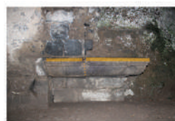
6. DEFORMAZIONE E ROTTURA
