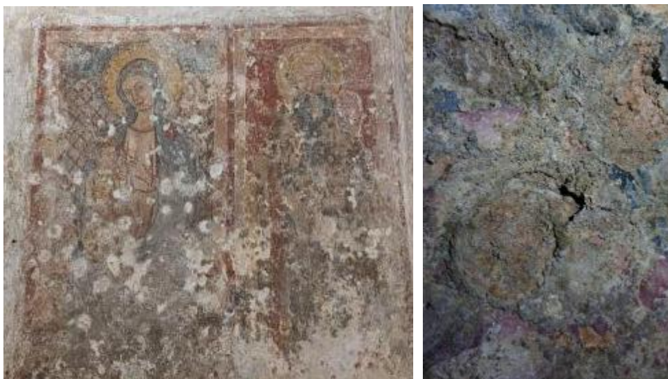
Fig. 1.2 Esempi di degrado su superfici affrescate in ambienti ipogei. A sinistra, Chiesa ipogea di Sotterra (Paola, CS): lacune dello strato pittorico e dell'intonaco, con diffusi fenomeni di imbianchimento superficiale che compromettono la leggibilità. A destra, Santa Maria della Grotta (Marsala): estese efflorescenze e sub-efflorescenze saline con formazione di concrezioni.
