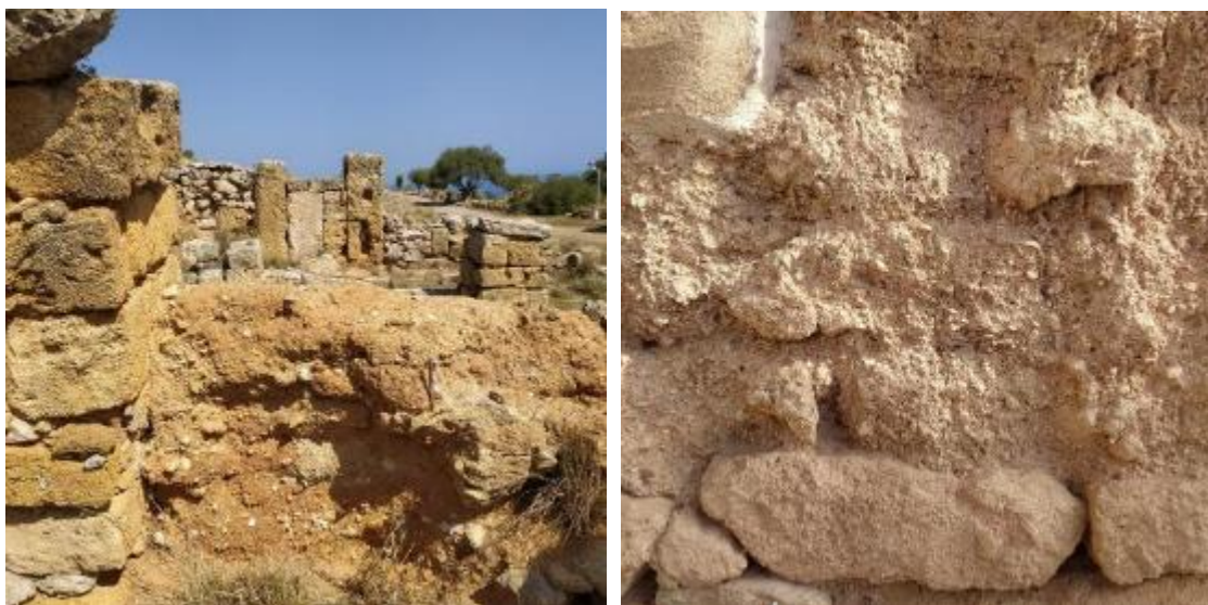
Fig. 1.5 Degrado di strutture in mattoni crudi presso l'area archeologica di Solunto (PA). A sinistra, vista d'insieme della muratura, in cui la porzione in mattoni crudi risulta arretrata rispetto ai blocchi litici, a causa di fenomeni di perdita di materiale e disgregazione. A destra, dettaglio della superficie, con evidenti fenomeni di decoesione e distacco del materiale costitutivo anche sotto minime sollecitazioni meccaniche.
