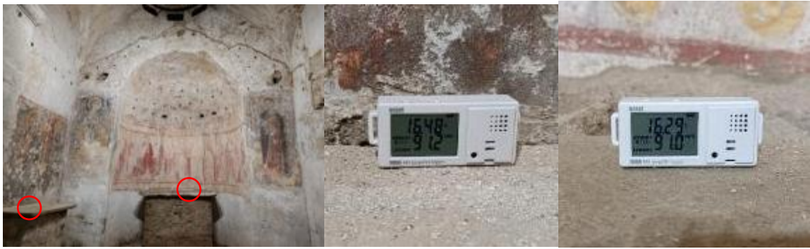
Fig. 3.40 Indicazione della posizione del datalogger (sinistra) Datalogger a sinistra del presbiterio (centro), Datalogger sull'altare dell'abside (destra)
