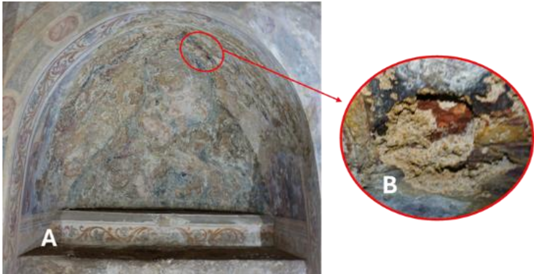
Fig. 3.14 Nicchia della Madonna della Grotta. (A) Vista generale dell'affresco, che mostra il grave stato di conservazione dovuto alla diffusa presenza di efflorescenze saline concrezionate che interessano sia l'intonaco sia gli strati pittorici. (B) Dettaglio di un'area degradata che evidenzia la presenza di strati pittorici sovrapposti riferibili a differenti fasi storiche.
