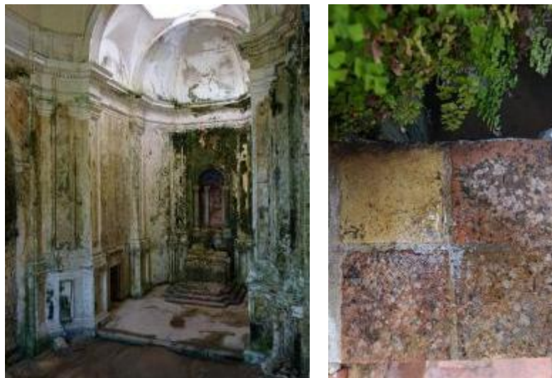
Fig. 1.6 Esempi di fenomeni di biodeterioramento su substrati lapidei. A sinistra: Complesso ipogeo di Santa Maria della Grotta (Marsala), sviluppo diffuso di patina algale sulle pareti della navata e dell'abside. A destra: tappeto di licheni su superfici in cotto della fontana del chiostro di Santa Maria di Gesù (Palermo).
