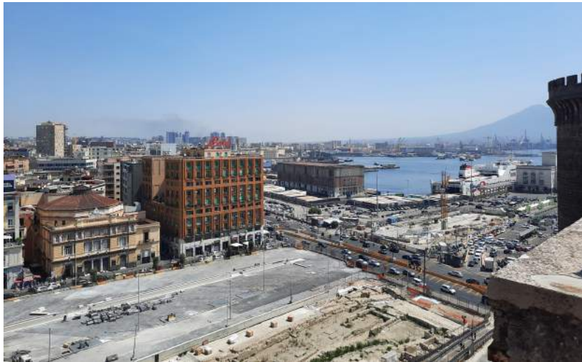
Fig. 17 Uno scorcio del porto di Napoli e del Molo Beverello con la stazione marittima e il cantiere della piazza Municipio con l'area archeologica che collega il waterfront alla città, vista dal Castel Nuovo. Foto: agosto 2021.
