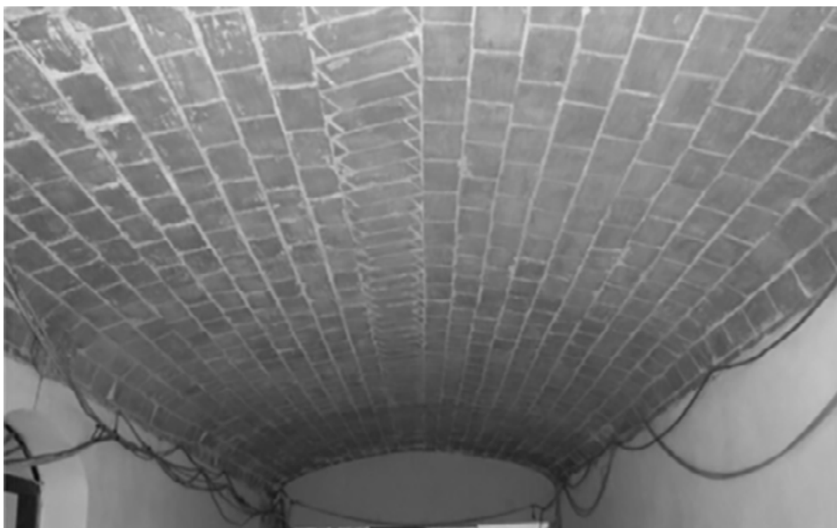
Fig. 7. Volta a botte realina, costruita intorno al 1860, presente a Palermo; da notare è la somiglianza del coronamento al sistema portoghese (Fatta et al., 2016).
