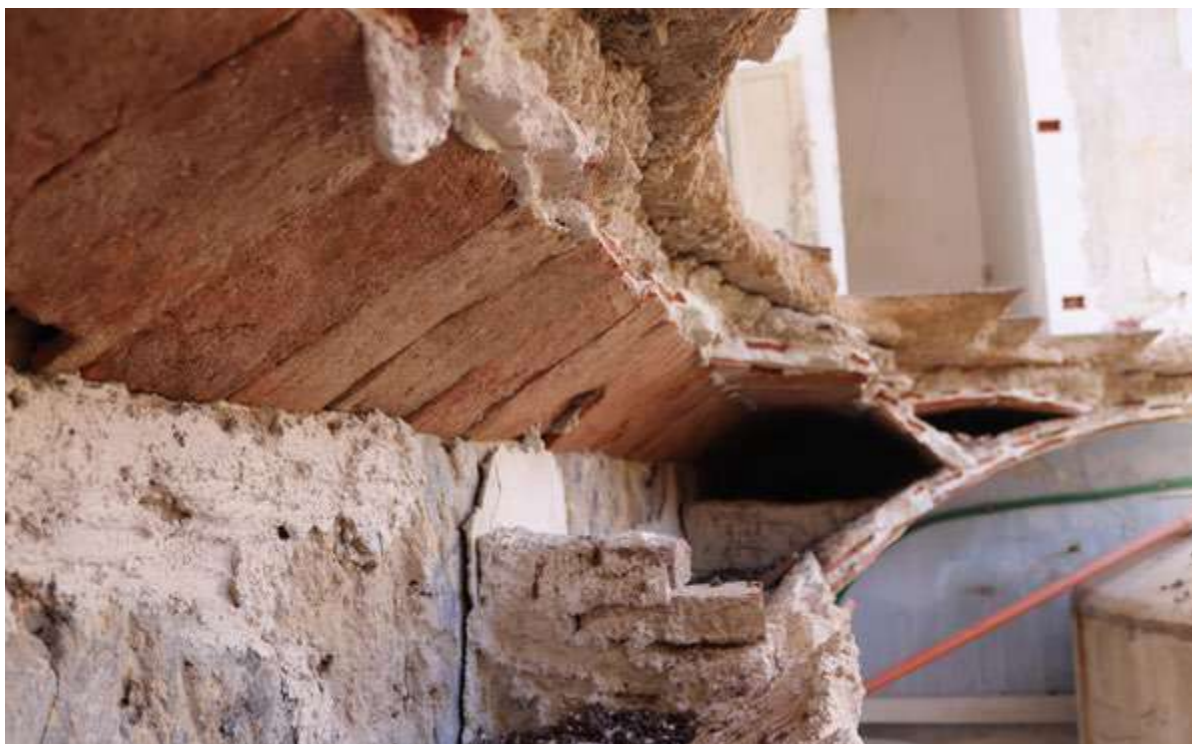
Fig. 8. Elementi di rinforzo di una volta a botte parzialmente crollata in via Levatrice a Partinico; si riconoscono due frenelli in mattoni e gesso e, in secondo piano, la sagoma della controvoltina e della doppia controvoltina (foto di D. Giardina).
