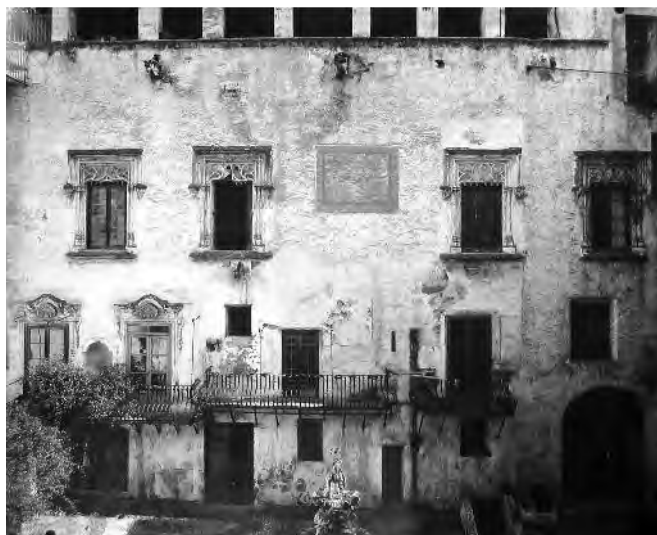
Fig. 4. Palermo. Palazzo Abatellis, prospetto nord-est della corte in cui è evidente la suddivisione interna del piano terra e in basso a destra la trasformazione dei livelli in prossimità del grande arco, con la presenza di un piano seminterrato e delle fontane addossate al prospetto (Archivio fotografico SBBCCAAP).
