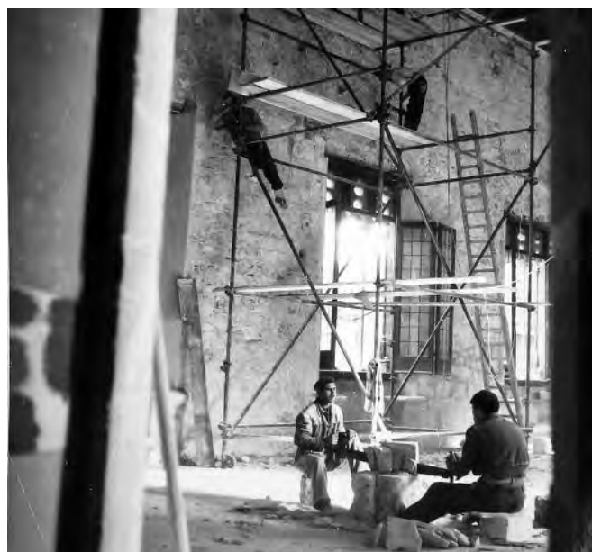
Fig. 17. Palermo. Palazzo Abatellis, operai che tagliano conci di biocalcarenite al primo piano del palazzo, nell'ala sud-ovest, in fase di ricostruzione (Archivio fotografico SBBCCAAP).
