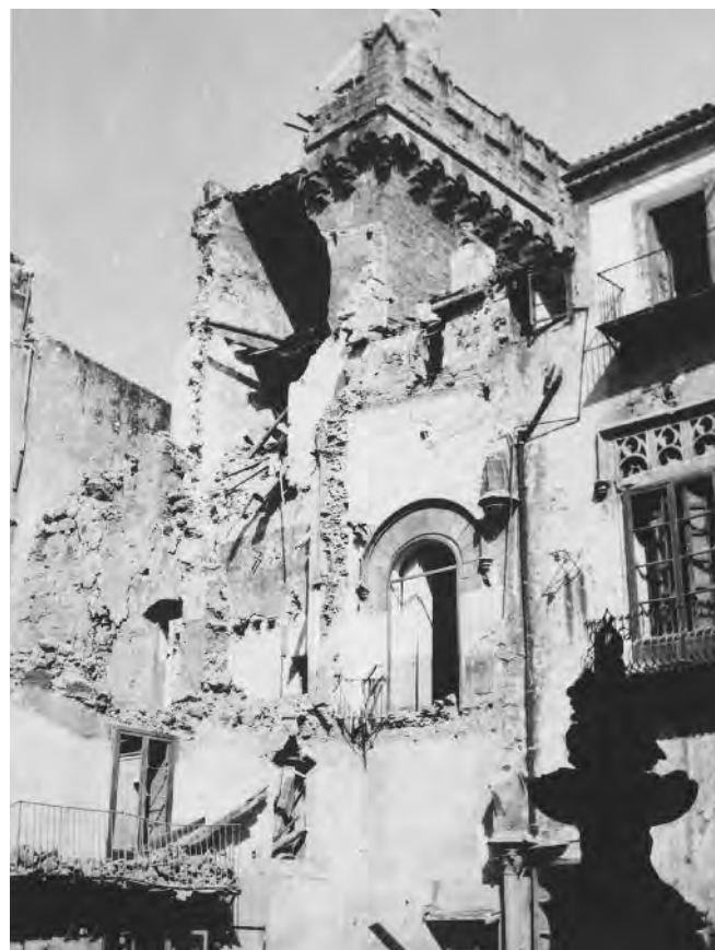
Fig. 9. Palermo. Palazzo Abatellis, crollo dell'ala sud-ovest, della torre e del loggiato (MBACT, ICCD - Archivio MPI, fondo P).
