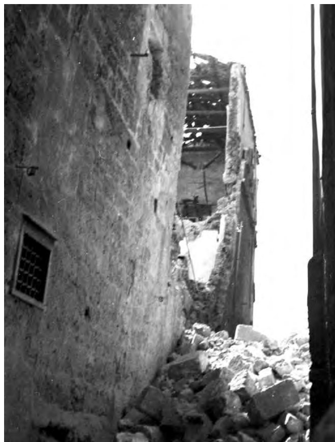
Fig. 8. Palermo. Palazzo Abatellis, vicolo della Salvezza, crollo dell'ala sud-ovest e del paramento esterno merlato (MBACT, ICCD - Archivio MPI, fondo P).
