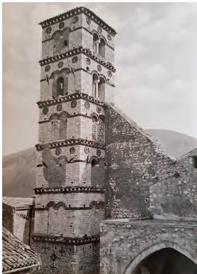
Fig. 15. Sermoneta (Latina). Santa Maria Assunta, il campanile prima dei restauri degli anni Quaranta; si notano il contrafforte e le bifore tamponate (ACS, Ministero Pubblica Istruzione, Direzione Generale Antichità e Belle Arti, Divisione II, 1940-1945, b. 115, fasc. Sermoneta chiesa di Santa Maria Assunta).
